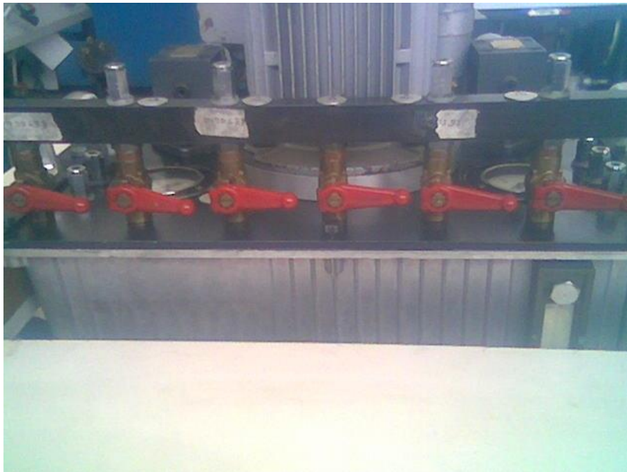
BLOQUE DE VÁLVULAS
