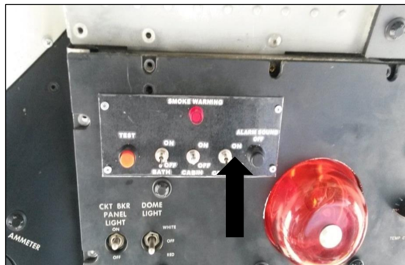
Figura 38: Panel de sistema de detección de humo
