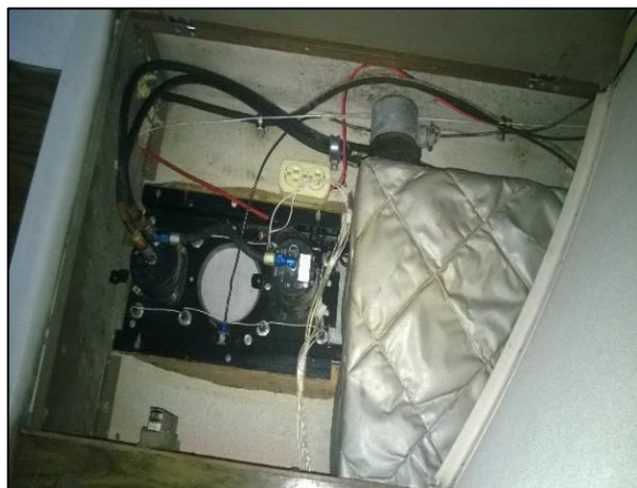
Figura 16: Cableado en el baño
