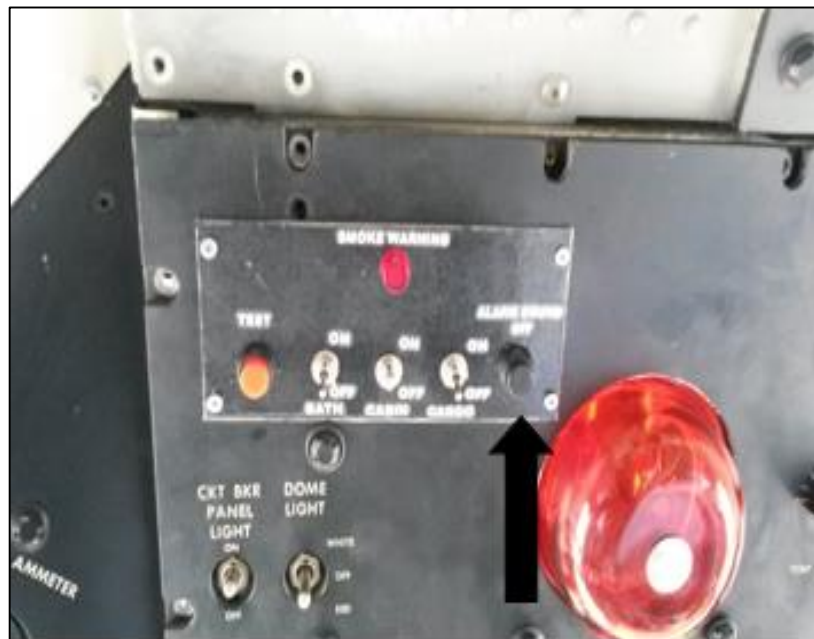
Figura 43: Panel de sistema de detección de humo
