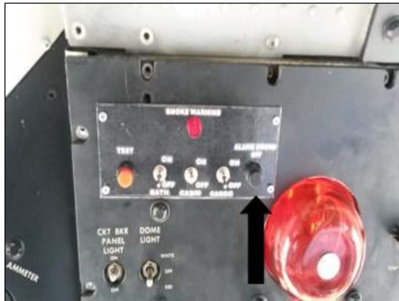
Figura 37: Panel del sistema de detección de humo
