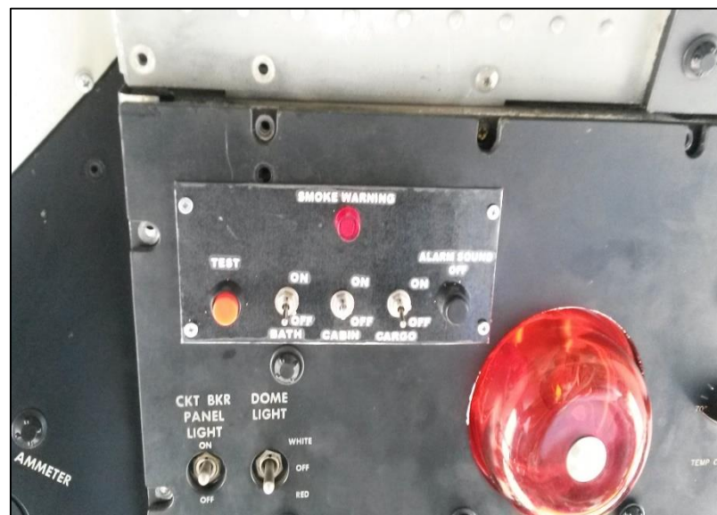
Figura 48: Panel de detección de humo
