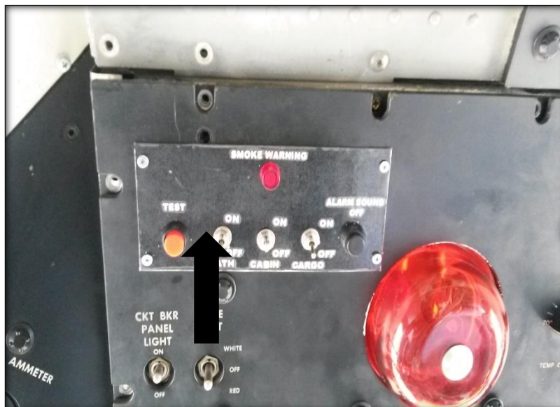
Figura 51: Panel de detección de humo
