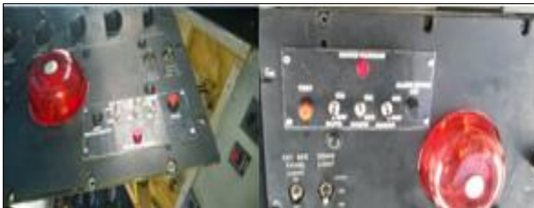
Figura 33 : Instalación del sistema de detección de humo
