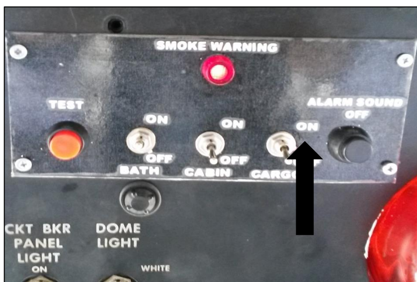
Figura 46: Panel de detección de humo.
