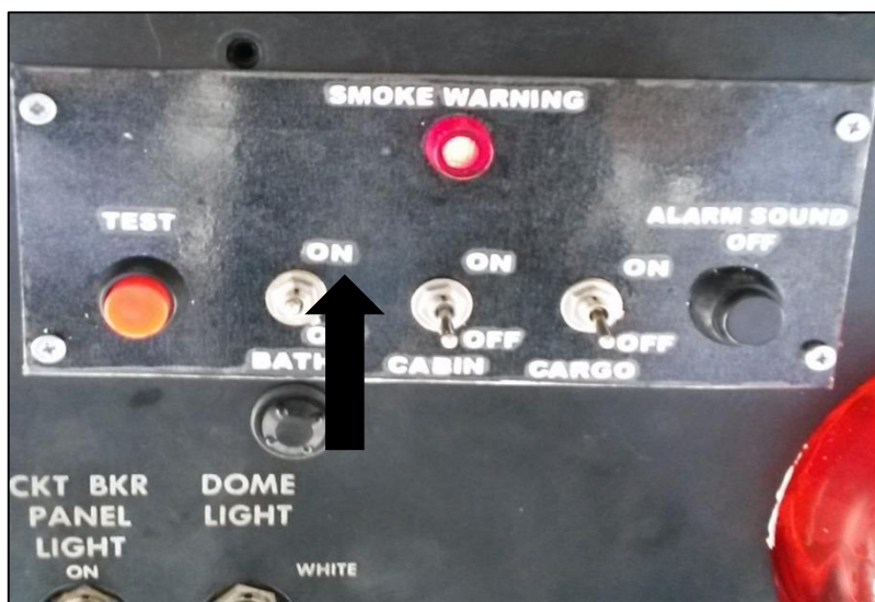
Figura 40: Panel de sistema de detección de humo
