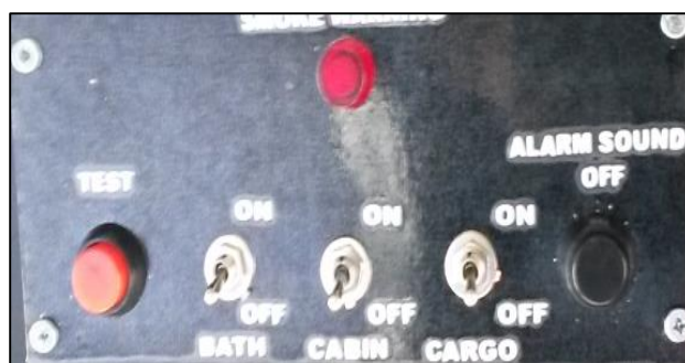
Figura 28: Panel del sistema de detección de humo
