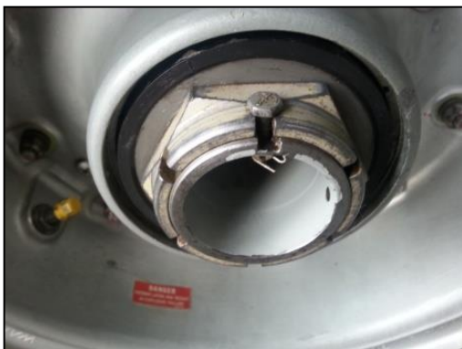
Figura 37. Rueda sin la cubierta de la placa
