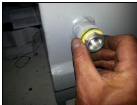
Figura 81. Colocación de la mirilla
