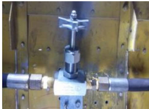
Figura 90. Ubicación de las válvulas
