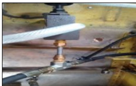
Figura 89. Ubicación de las válvulas
