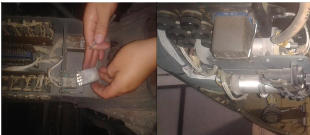
Figura 3. 26 Montaje de los relés en los paneles de fusibles y corazón eléctrico
