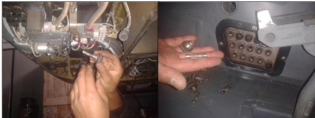
Figura 3. 21 Colocación de los fusibles nuevos en los paneles de fusibles
