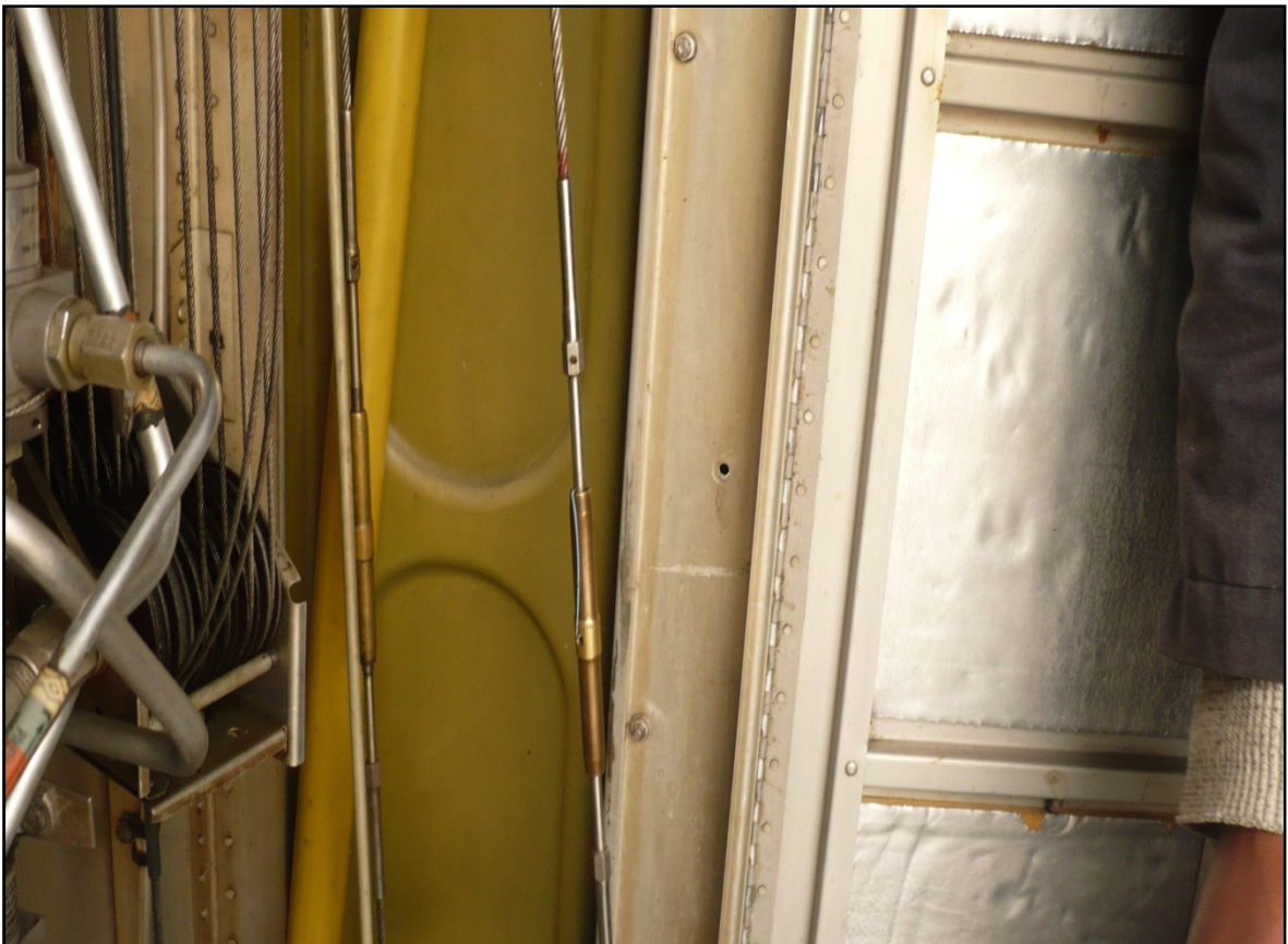
Figura 2.23: Turnbuckles de los cables del timón de dirección
