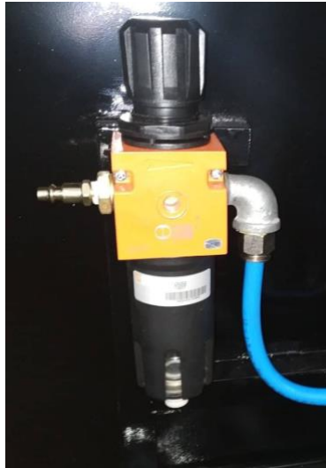
Figura 42 Filtro regulador instalado.
