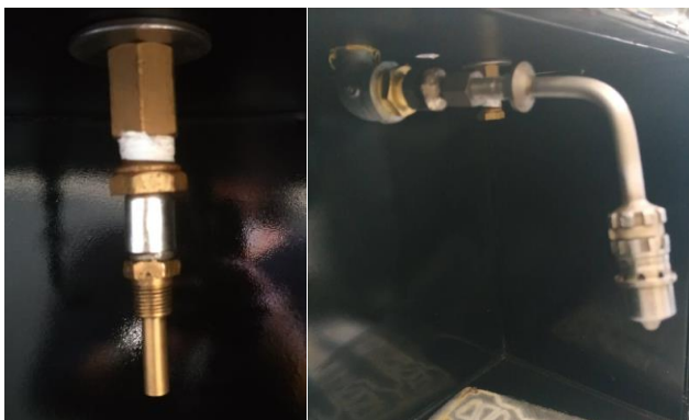
Figura 55 Inyectores instalados en los acoples.
