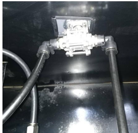
Figura 47 Cañerías a los actuadores eléctricos.
