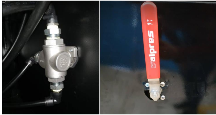
Figura 48 Conexiones de las cañerías a la válvula.
