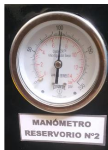
Figura 12 Manómetro Reservorio N°2
