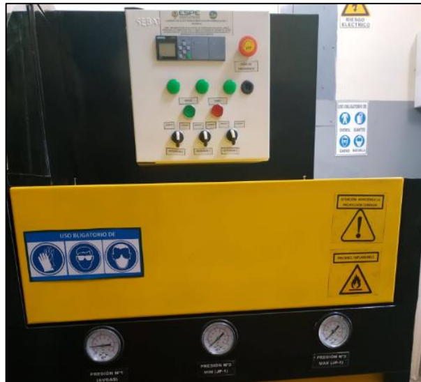
Figura 60 Señalética de seguridad colocada.
