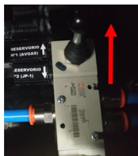
Figura 3 Válvula Neumática en posición "RESERVORIO N°1"
