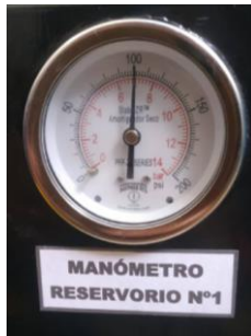
Figura 4 Manómetro Reservoir N°1
