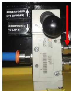
Figura 11 Válvula Neumática en posición "RESERVORIO N°2"
