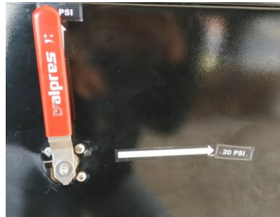
Figura 19 Válvula de distribución en posición 50psi
