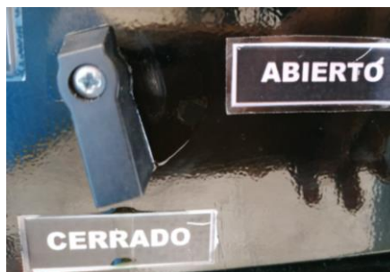
Figura 9 Válvula de Bola manual Cerrada
