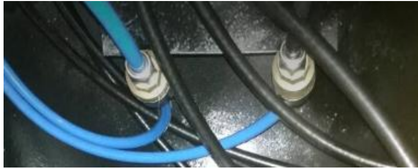
Figura 44 Conexión de las válvulas check.
