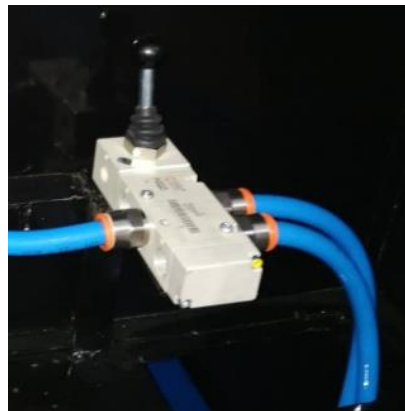
Figura 43 Válvula neumática instalada.
