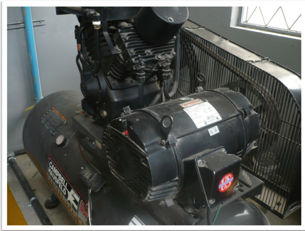
Figura 3.9. Estado actual del compresor de aire que da abasto a la red neumática
