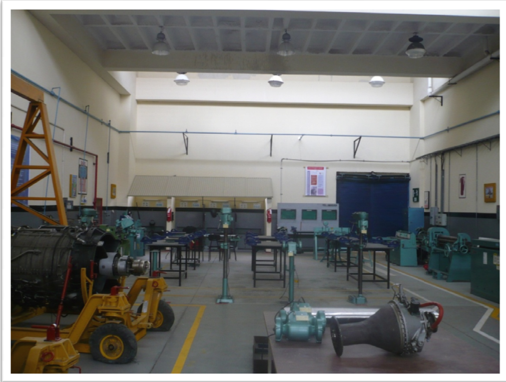
Figura 3.7. Estado actual de la red neumática.
