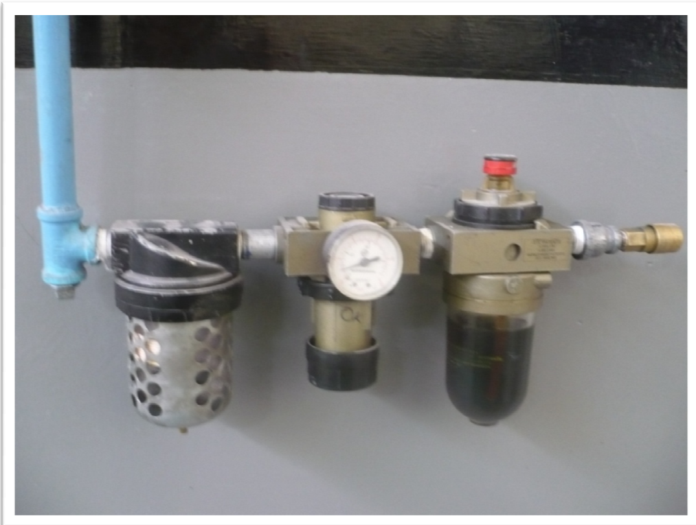
Figura 3.8. Estado actual de las unidades de filtro regulador lubricador
