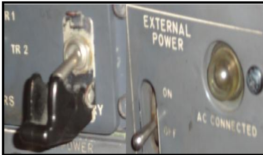
Figura 3.3: Switches de la batería y de la planta externa Elaborado por: Jonathan Zurita
