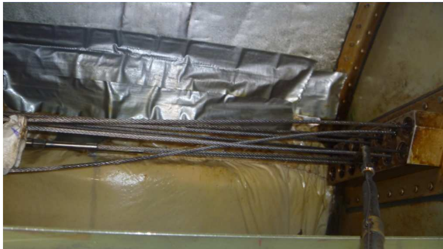
Figura 3.8: Overhead panels abiertos
