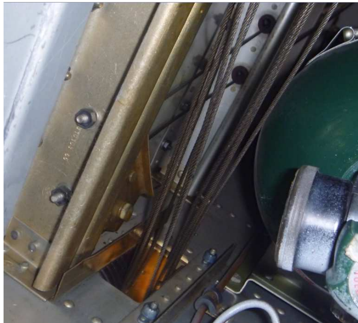
Figura 3.7: Cables detrás del compartimento neumático
