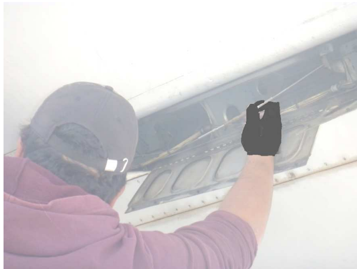
Figura 3.16: Desconexión de los turnbuckles en el alerón derecho
