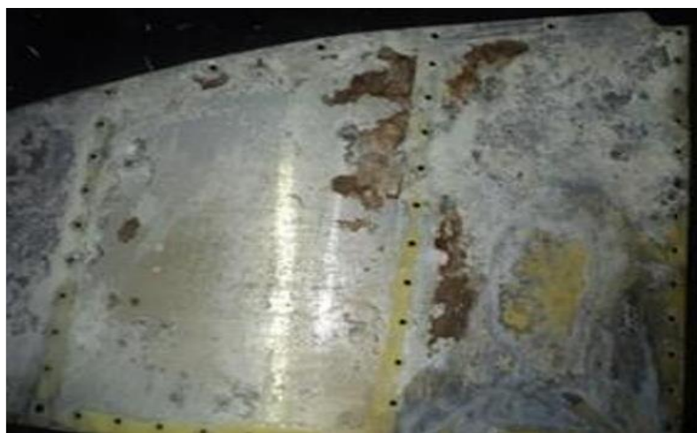
Figura 2 .26. Corrosión por Picadura
