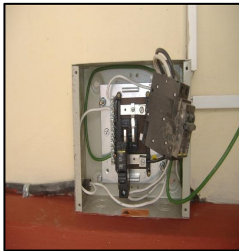
Figura 3.32 Corte de suministro eléctrico
