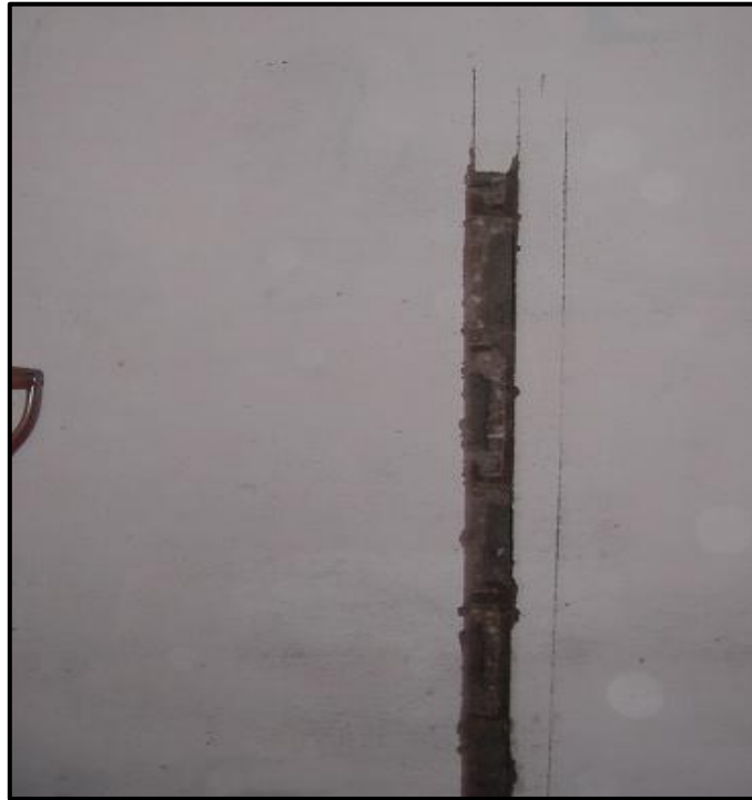
Figura 3.34 Picadura de las paredes
