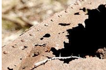
Figura 17: Oxidación de metal
