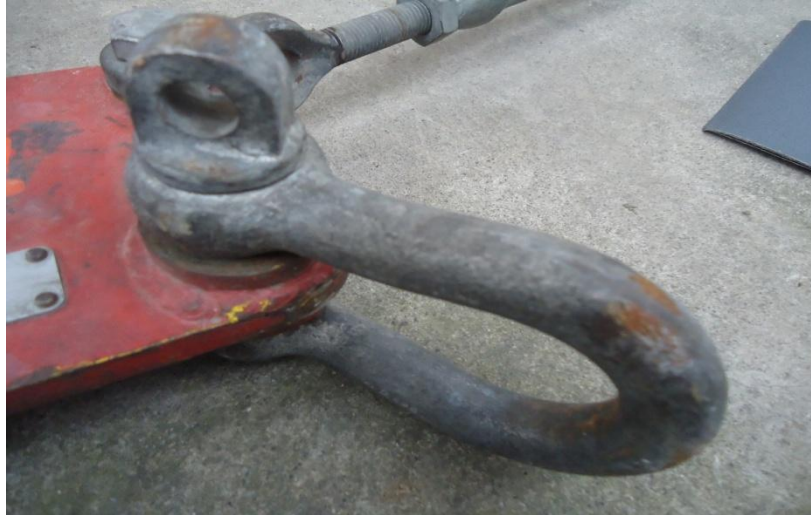
Figura 21. Grillete en mal estado
