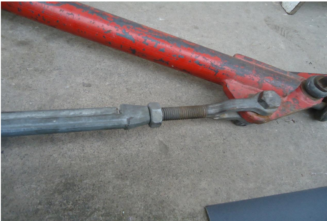
Figura 20. Soporte en mal estado
