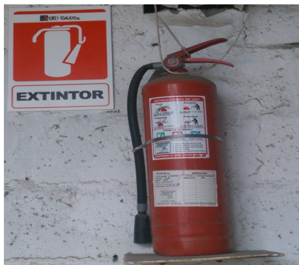
Figura N° 3.43. Extintor Fuente: Empresa Flores Toacaso S.A. Elaborado por: Ramos Evelyn
