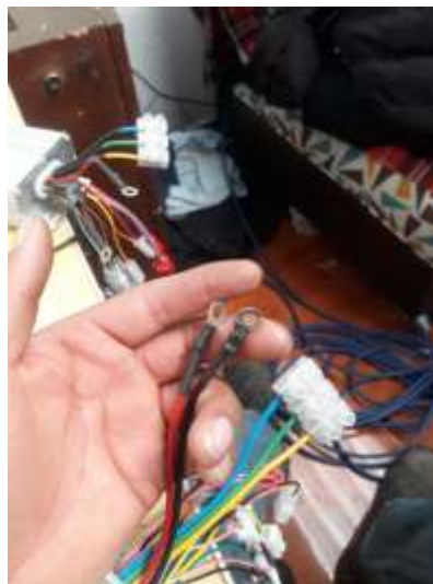
Cables de conexión de alimentación y control del motor
