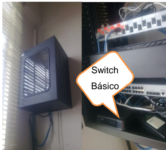
Figura 48. Instalación del Switch en el interior del Rack
