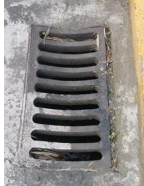
Rejillas limpias, sin basura acumulada
