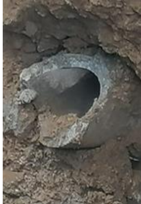
Tubería de hormigón deteriorada por el tiempo
