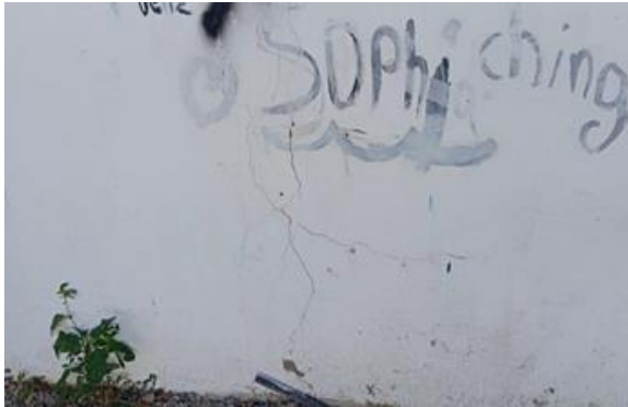
Patologías en Paredes
