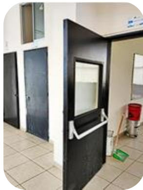
Puertas o salidas de emergencia
