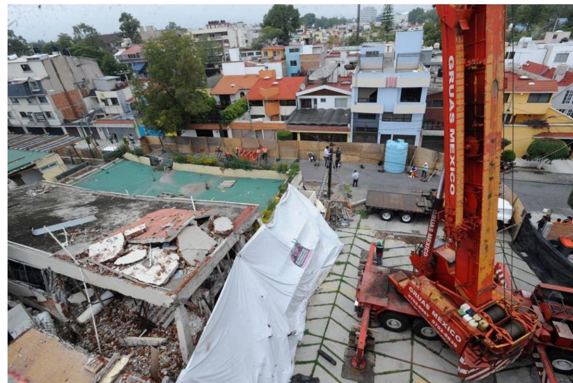
Maquinaria pesada recogiendo escombros en el Colegio Enrique Rebsamen, parte del inmueble colapsó en el sismo del 19 de septiembre de 2017.
