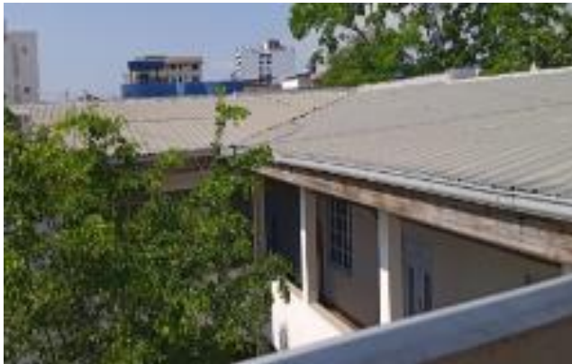
Condición de golpeteo
