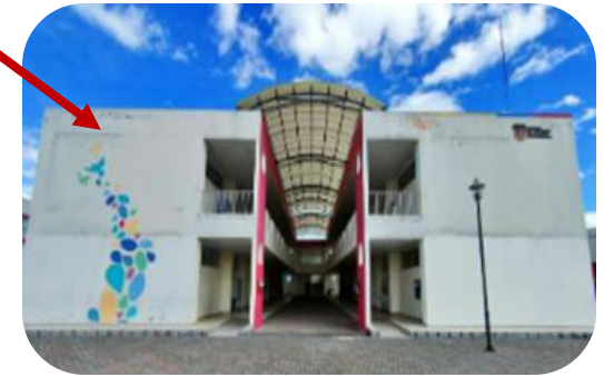
E1 Edificio de aulas Tipo C3 Irregularidad en planta
