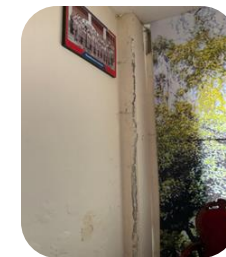
Patologías en Columnas
