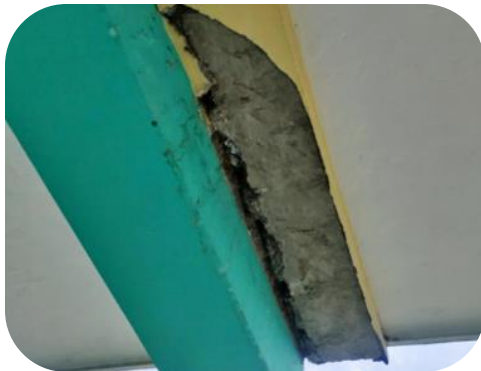
Condición de golpeteo
