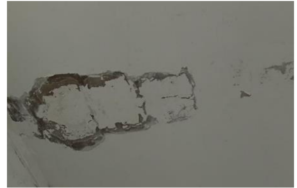
Patologías en Losas
