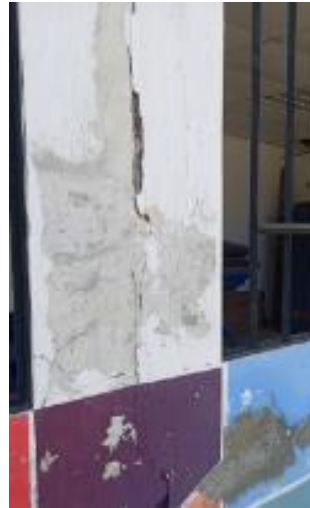
Patologías en Columnas
