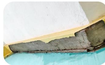
Patologías en Vigas
