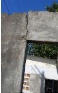
Patologías en Vigas
