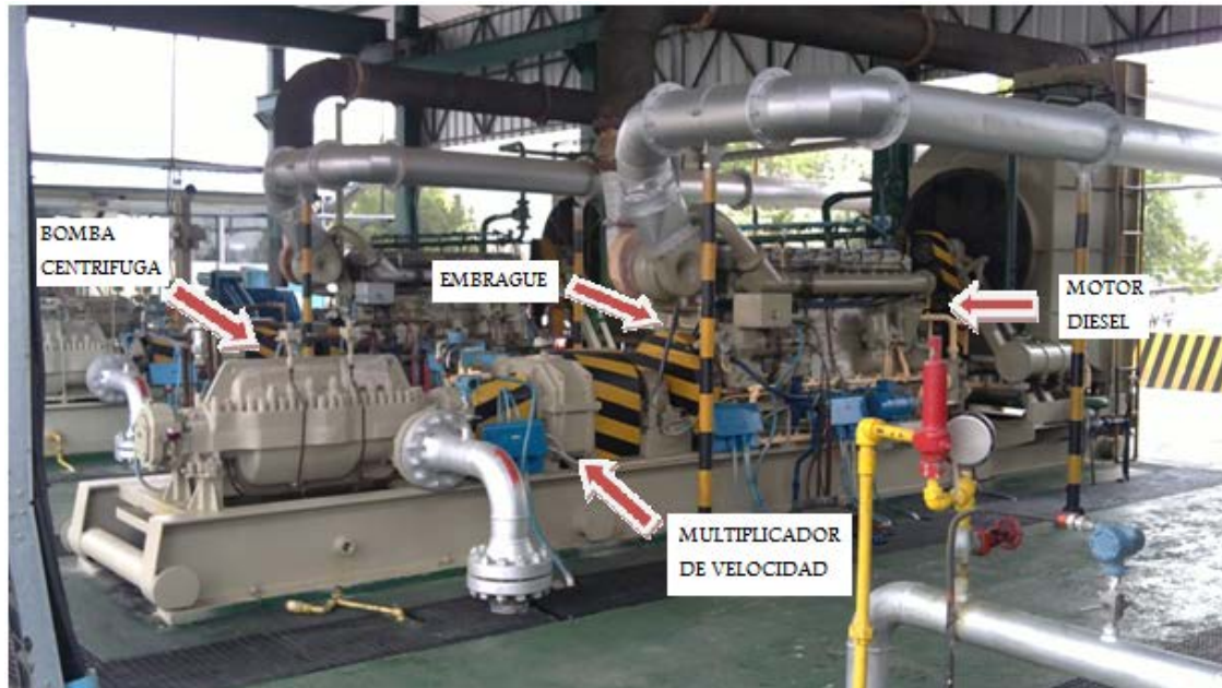
Figura 1.10. Vista Lateral del Grupo de Bombeo Diesel
