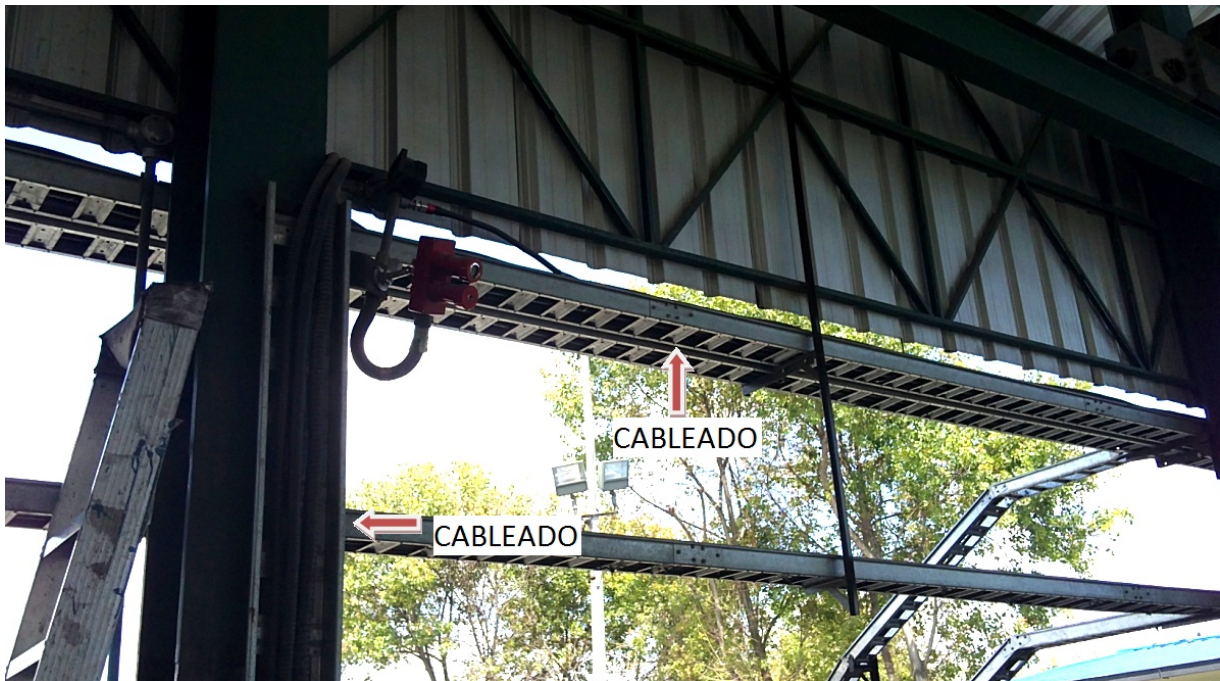
Figura 4.17.Ubicación del Cableado Anterior
