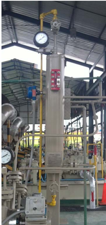
Figura 3.9. Tanque de reserva
