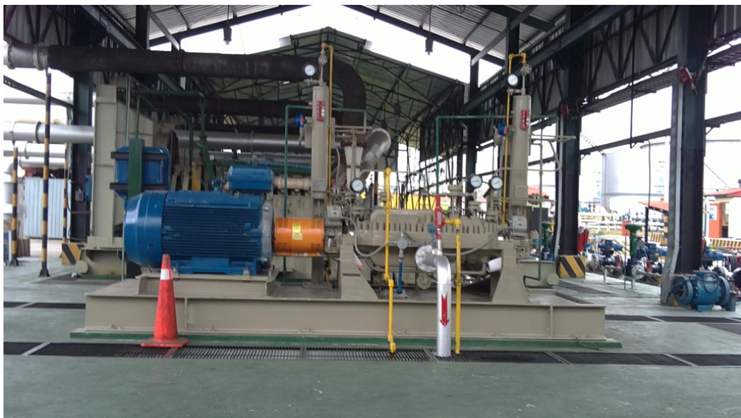
Figura 1.11. Grupo de Bombeo Eléctrico
