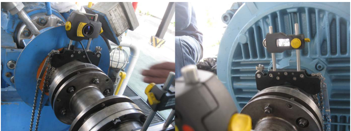
Figura 4.16. Alineación Motor - Bomba
