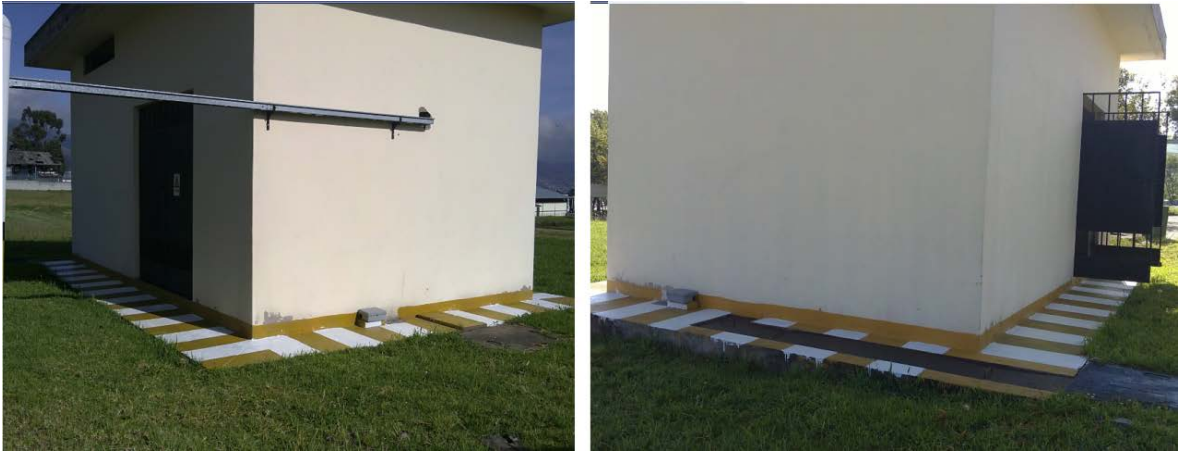
Figura 4.38. Vista Exterior del Cuarto del Variador de Velocidad
