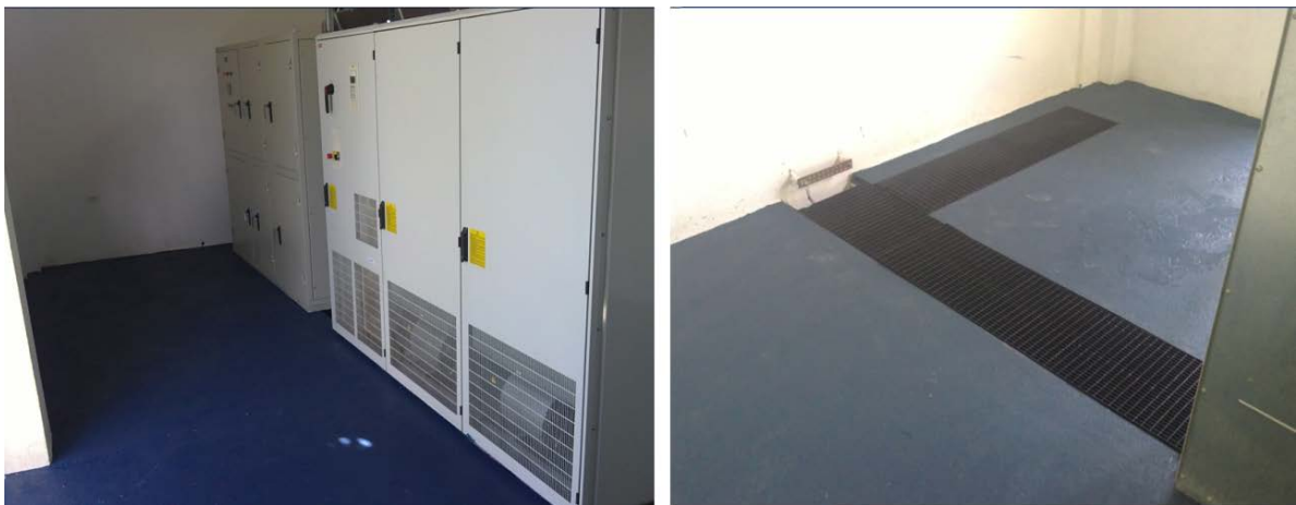
Figura 4.39. Vista Interior del Cuarto del Variador de Velocidad
