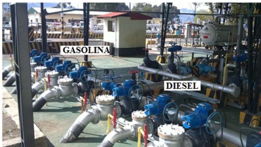
Figura 1.3. Manifold de válvulas
