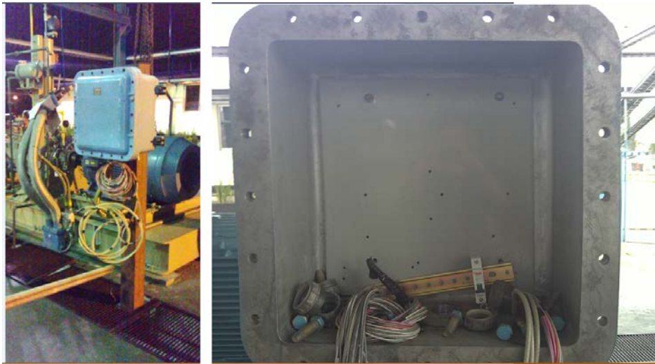
Figura 4.25. Cableado en el Pedestal y en Caja de Conexiones
