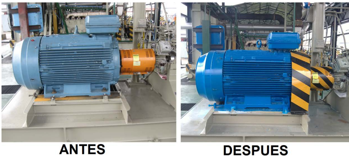
Figura 4.35. Vista Final del Motor Eléctrico
