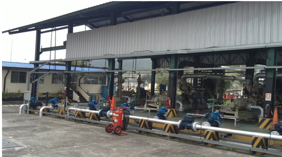
Figura 1.8. Grupos de Bombeo y Cuarto de Control
