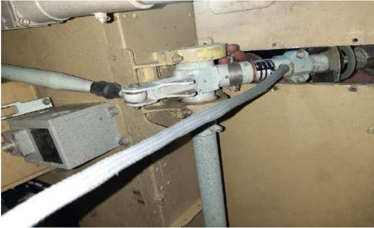
Inspección del cableado del SAS
