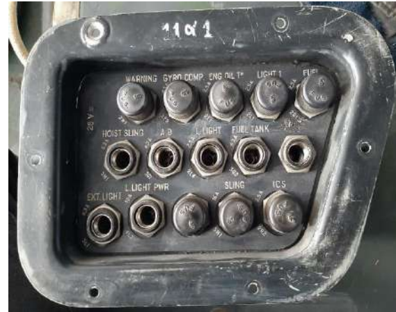
Inspección del panel de distribución 11α1
