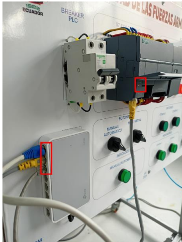
Conexión con cable Ethernet
