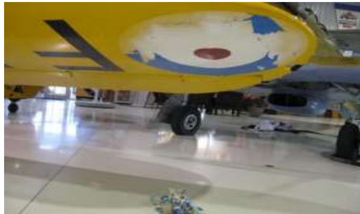
Adherencia y elevación de la pintura
