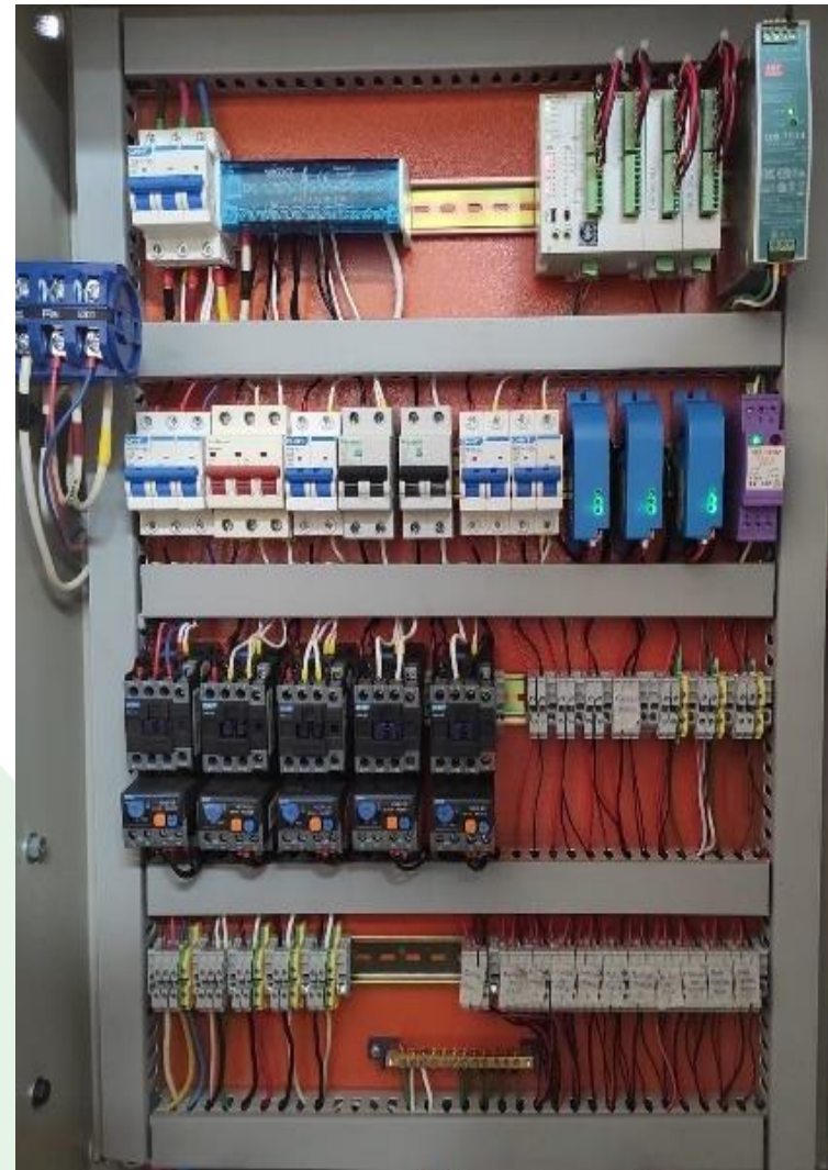
Figura 19 Distribución de los componentes en el tablero de control
