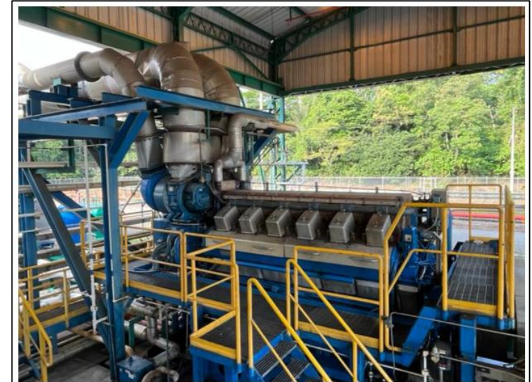
Figura 6: Fotografía motor Wärtsilä 12V32LN.
