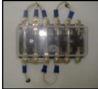
Figura 3.4.- Caja de fusibles
