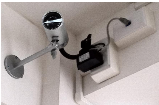
Figura 3.6: Ubicación cámara IP
