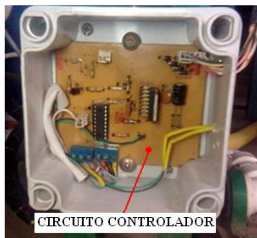
Figura 4.13 Ubicación del circuito controlador SERVL298 12-06.
