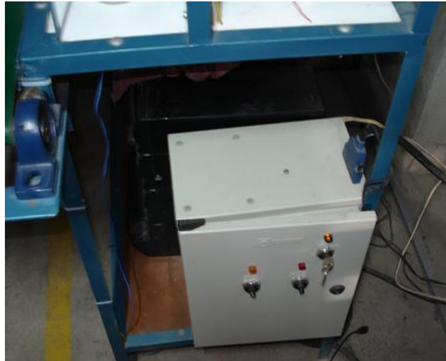
Figura 4.18 Parte frontal del tablero principal.
