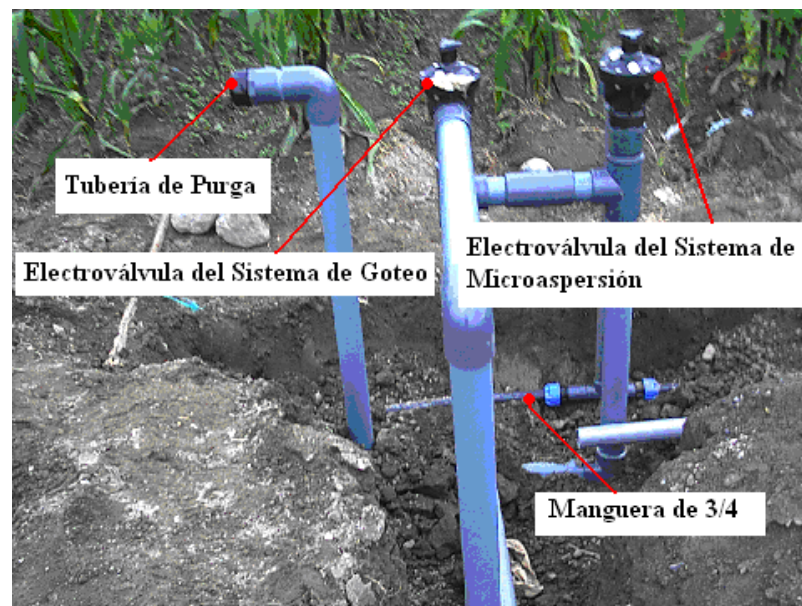
Figura 4.3 Instalación física del distribuidor.
