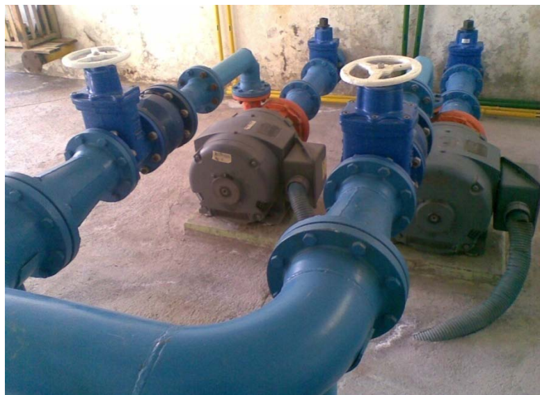
Figura 2.7. Estación de Bombeo Selva Alegre
