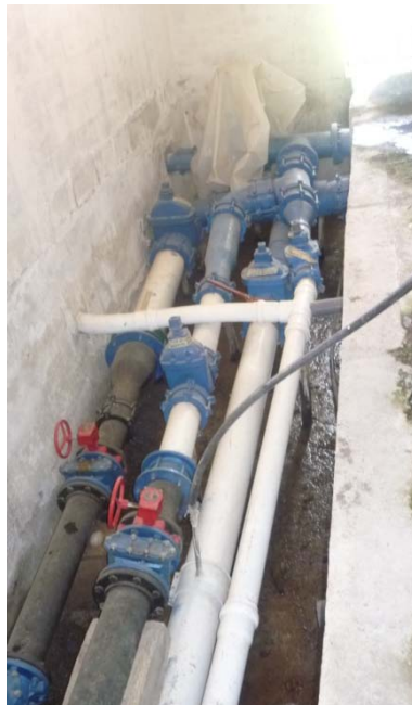
Figura 2.13. Tanque Dolores Vega (Tuberías de salida)
