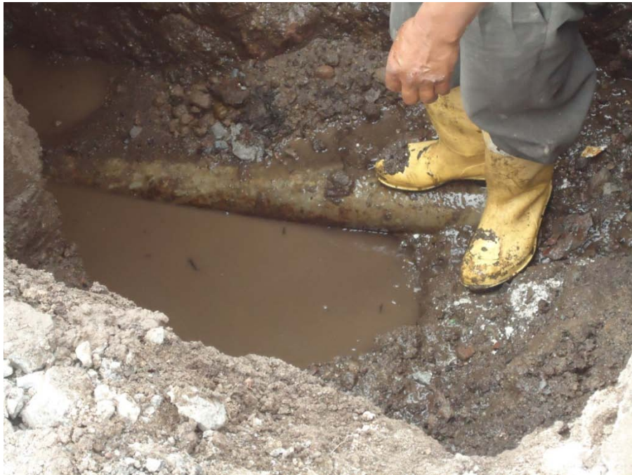
Figura 2.18. Tubería Asbesto Cemento 110 mm, Nodo E.R.72 – E.R.73
