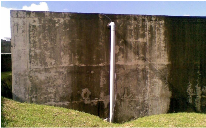
Figura 2.12. Tanque Dolores Vega (Tubería de entrada)
