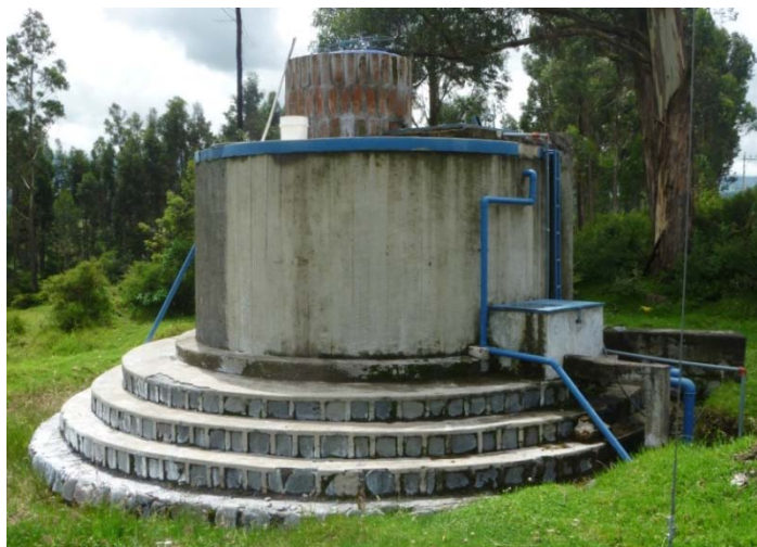
Figura 2.15. Tanque Barrio Cashapamba
