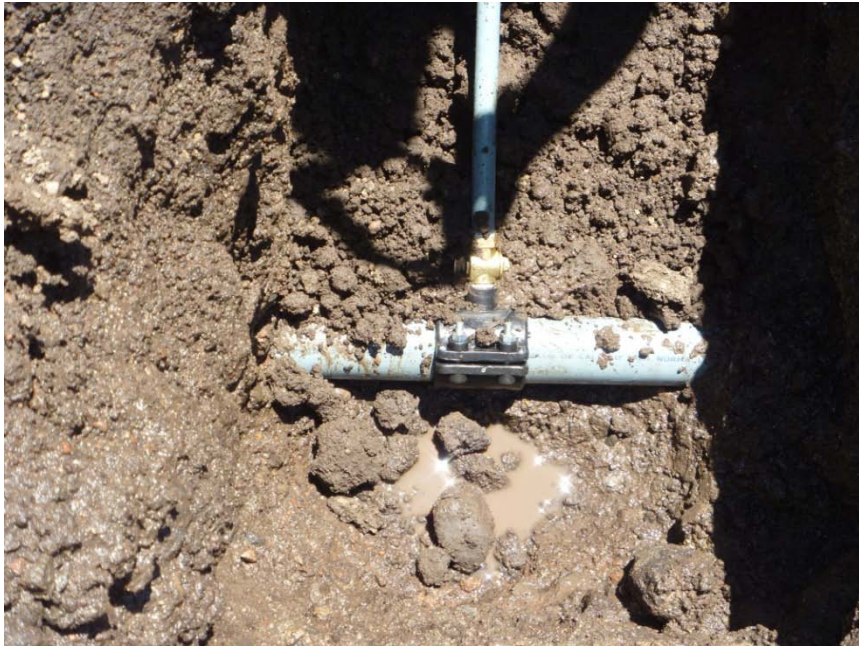
Figura 2.17. Tubería PCV 63 mm, Nodo BC 24 – BC 23
