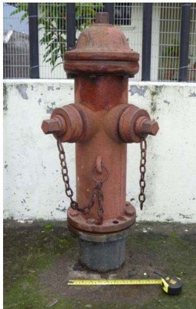
Figura 2.22. Hidrante Zona 15: La Colina
