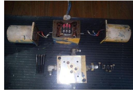
Pruebas eléctricas en las electroválvulas
