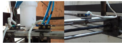
Figura 28.: Micros switch ubicados transversales.
