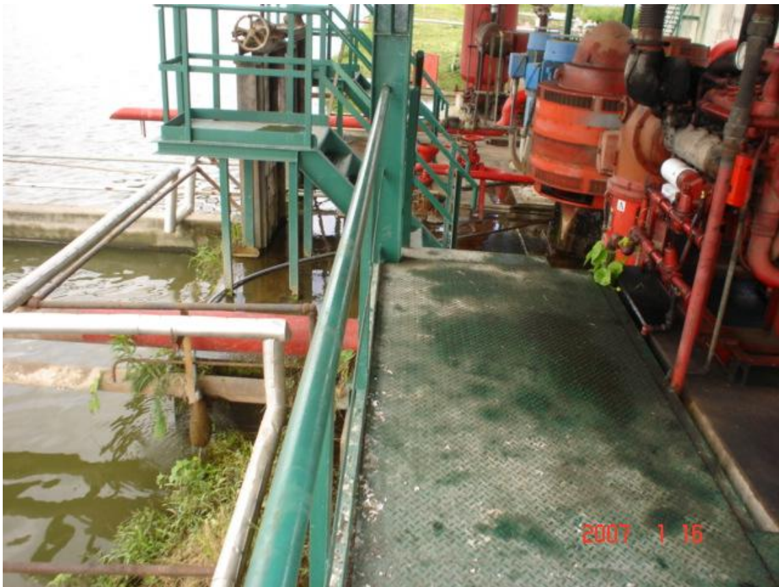
Figura 1.1 Sistema de bombeo red contra incendios REE.
