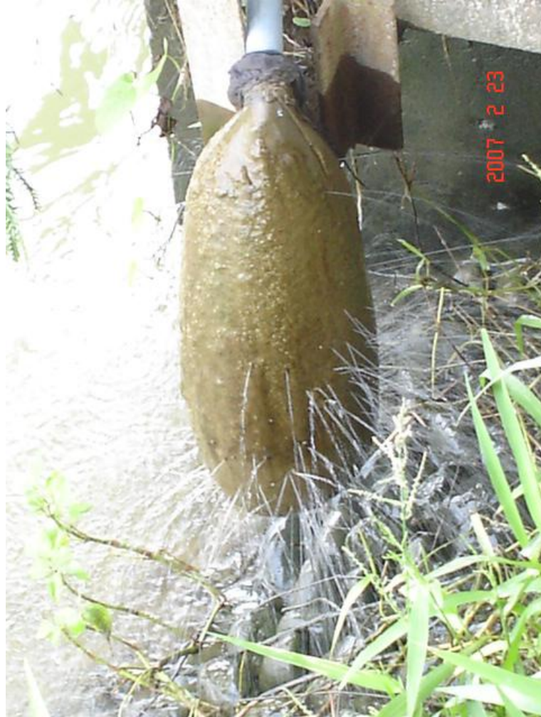
Figura 2.1 Trampa de fango instalada en el sistema de bombeo REE.
