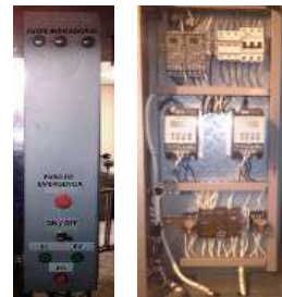
Figura 10: Talero de Mando y Control
