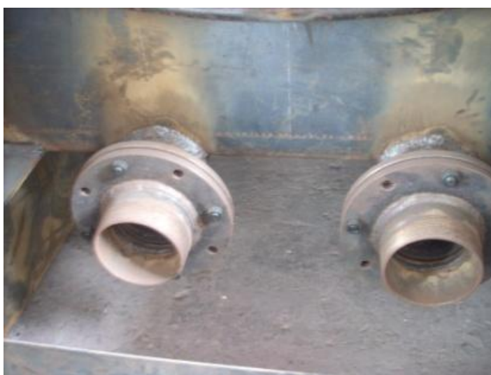
Fotografía 42: Tubos de Descarga Vista Anterior
