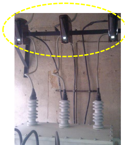
FIGURA 53 SECCIONADOR TRANSFORMADOR N° 7
