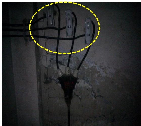
FIGURA 60 SECCIONADOR TRANSFORMADOR N° 10
