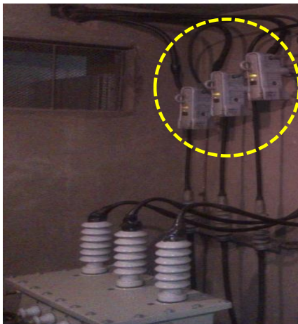
FIGURA 47 SECCIONADOR TRANSFORMADOR N° 4
