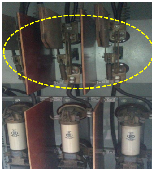
FIGURA 57 SECCIONADOR TRANSFORMADOR NRO. 9
