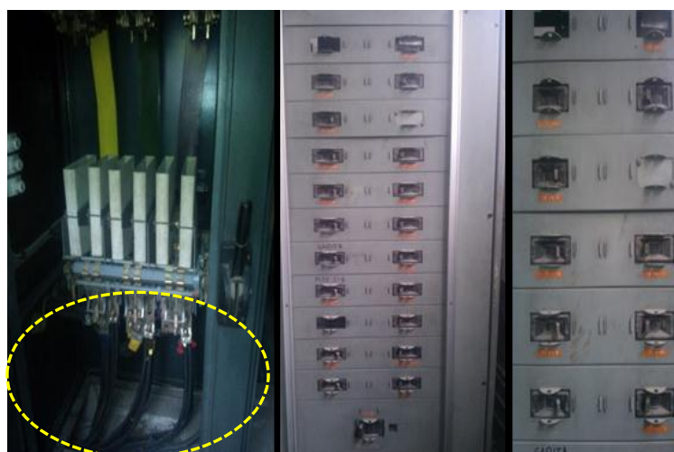
FIGURA 40 BARRA Y TABLERO DE DISTRIBUCIÓN PRINCIPAL
