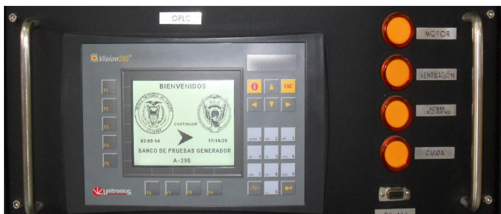
Figura 3.26. Módulo OPLC implementado.
