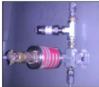
Figura 1. Instalación del Transductor NEW – FLOW (PT3100)
