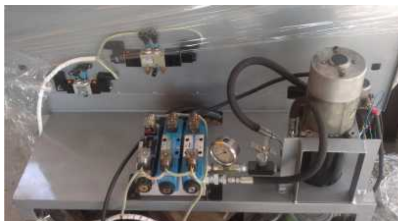
Figura 6.15. Conjunto de válvulas y bomba hidráulica
