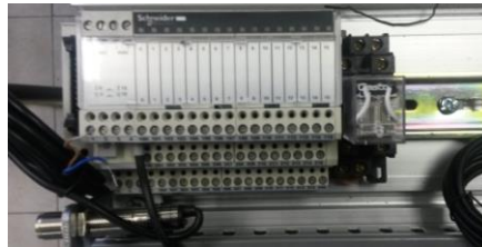
Figura 4.50 Módulo de entradas y salidas.
