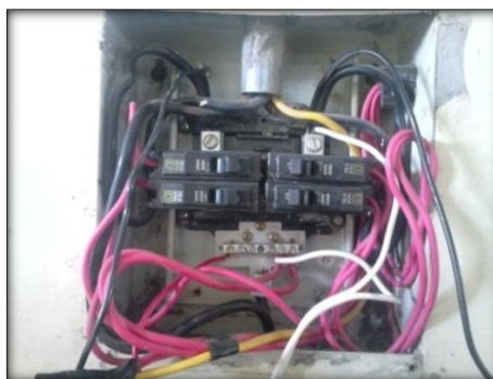
Figura 4.1 Caja de Breakes Existente en el Laboratorio.
