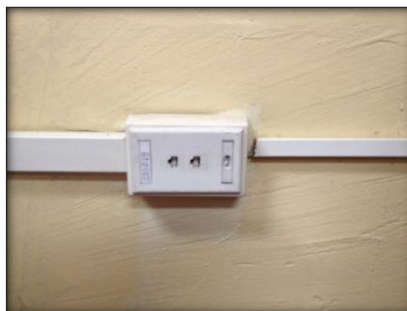
Figura 4.3 Infraestructura de la red de datos del Laboratorio de sistemas de Comunicaciones
