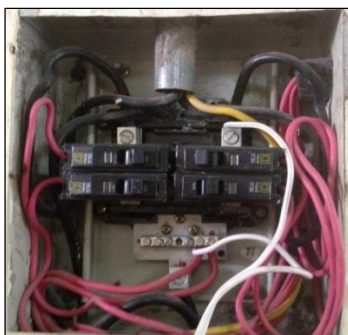
Figura 4.105 Caja de breakers del Laboratorio.
