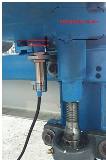
Figura 3. 18 Montaje de los sensores en los sistemas de elevación
