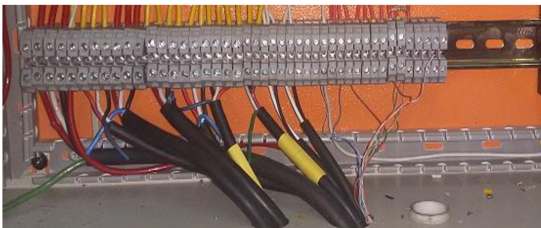
Figura 3. 16 Borneras individuales de conexión
