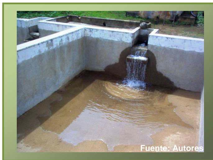
Foto No.8: Planta de tratamiento “La Esperanza” (control por cloro)
