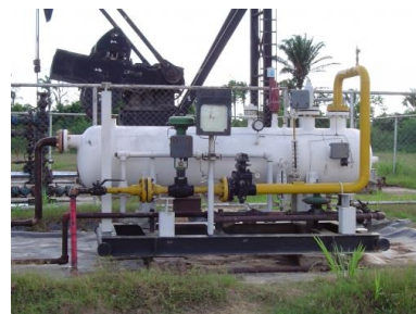
Figura 1. Separador de prueba.
