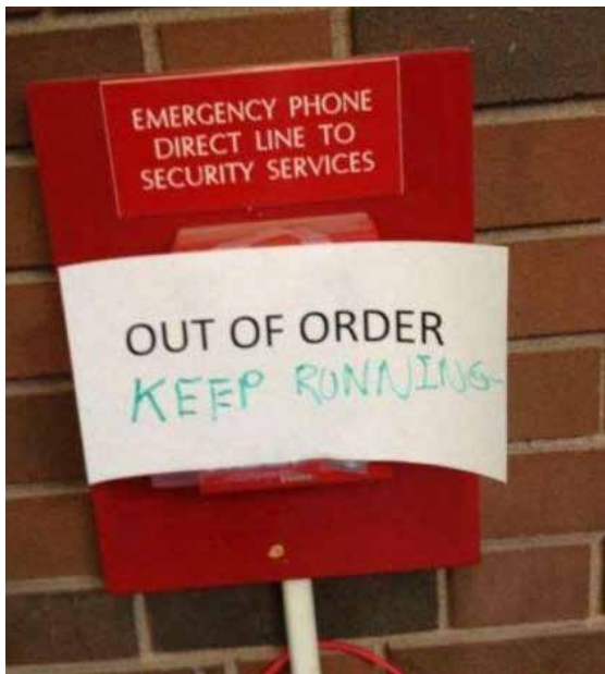
Fig. 4.16, Teléfono de emergencia, línea directa hacia los servicios de seguridad – Fuera de servicio, sigue corriendo. De Facebook
