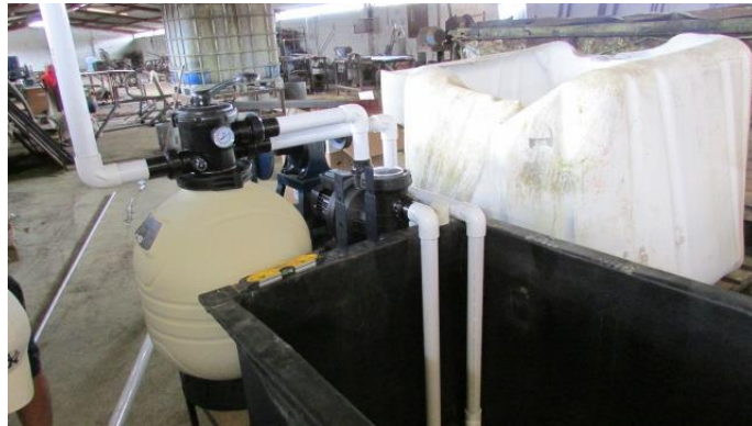
Figura 4. 17. Sistema de Filtrado.
