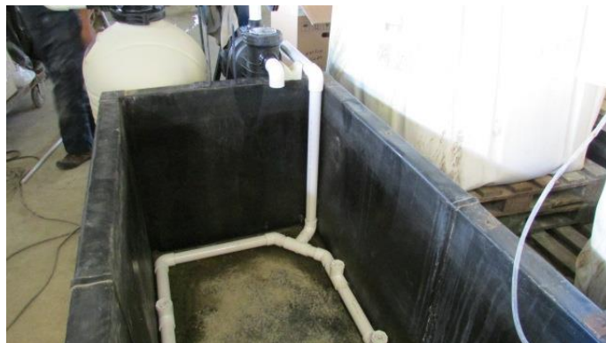
Figura 4. 13. Acople de la tubería con la Bomba
