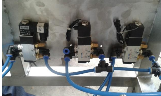
Figura 4. 26 Localización de electroválvulas
