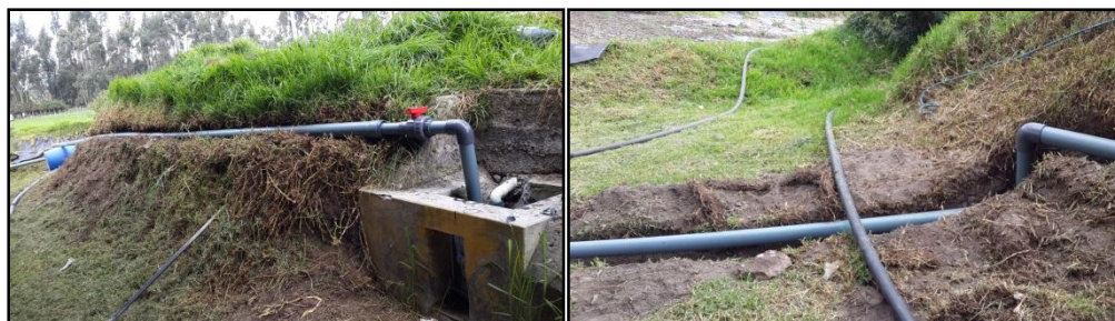
Figura 3. 4. Línea de biogás.
