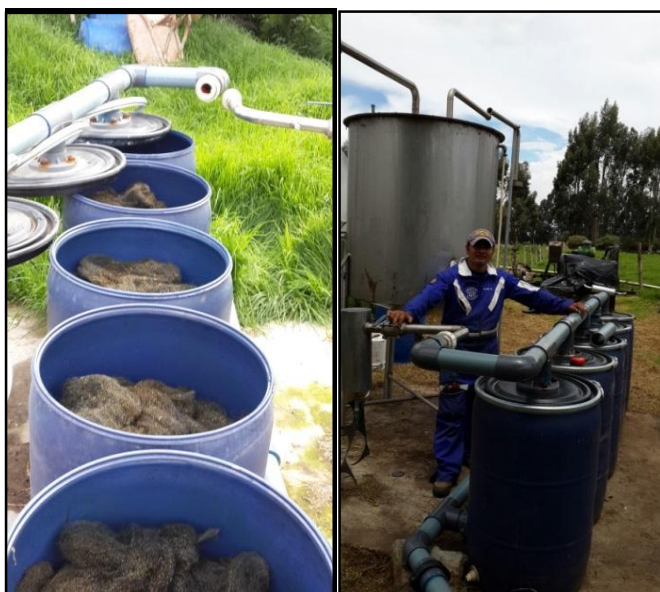
Figura 3. 6. Filtro de H 2 S terminado.
