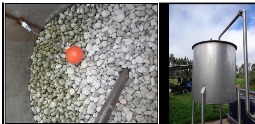
Figura 3. 8. Tanque de anti explosión.
