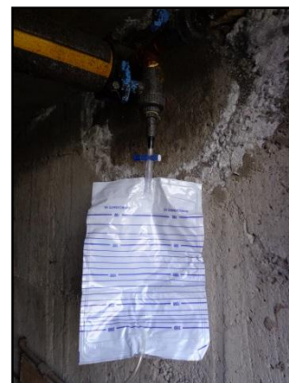
muestra de biogás en el biodigestor.
