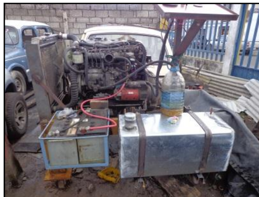
Figura 3. 13. Tanque de combustible.
