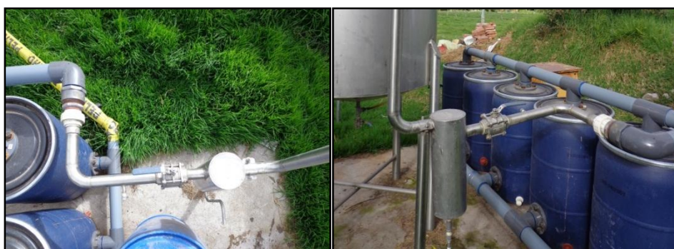
Figura 3. 7. Trampa de condensado rehabilitado.
