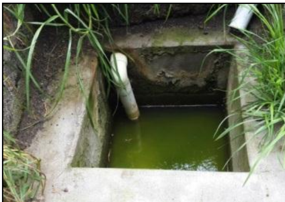
Figura 2. 3. Tanque de nivel de agua con su tubería de dos pulgadas.
