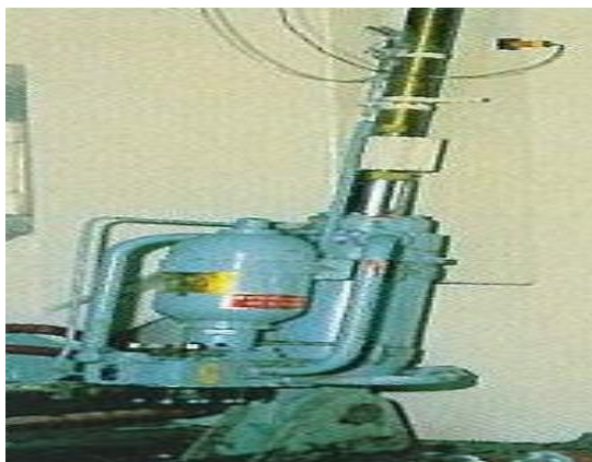
Figura 28: Acumulador del Molino de Crudo
