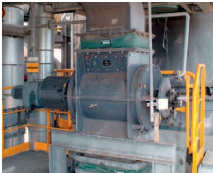
Figura 32: Válvula de Clapeta del Molino de Crudo
