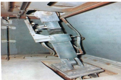
Figura 27: Cilindro Hidráulico del Molino de Crudo
