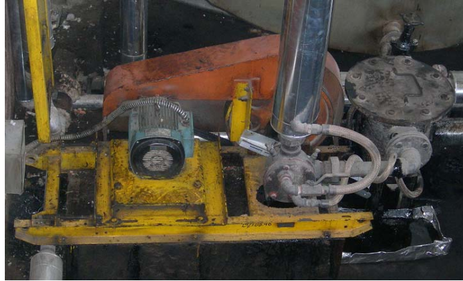
Figura 3.4 Bomba de Asfalto
