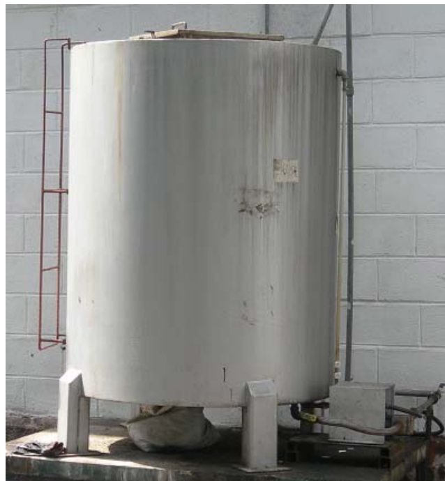
Figura 3.6 Tanque de Aceite Plastificante
