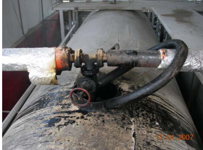
Figura 3.3 Tanque de almacenamiento de asfalto
