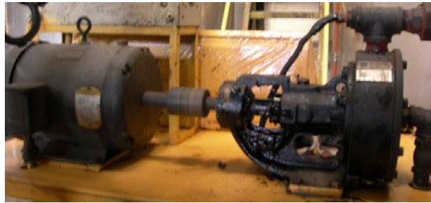
Figura 3.10 Unidad de molino coloidal – motor eléctrico
