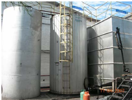
Figura 3.11 Tanques de almacenamiento de producto terminado
