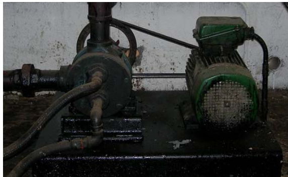
Figura 3.12 Bomba de alimentación de producto terminado hacia tanques de almacenamiento
