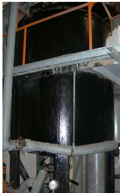
Figura 3.5 Tanque de premezcla
