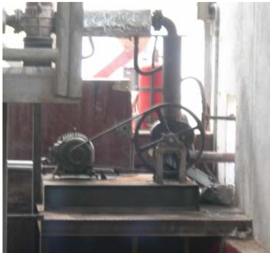
Figura 3.2 Bomba de descarga de asfalto.
