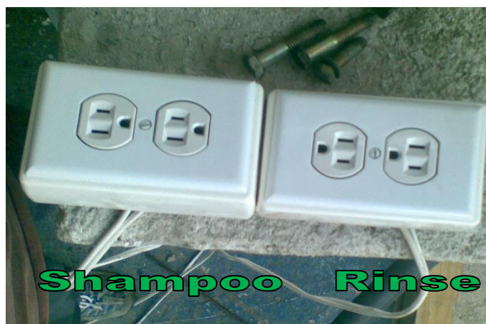
Fig. 5.6.1 Tomacorrientes energizados por el PLC 173
