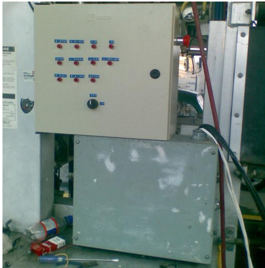
Fig. 5.7.3 Vista del estado final de sujeción del tablero de control 179
