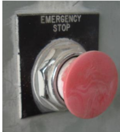
Fig. 3.1.2.1.6.1 Interruptor de emergencia 78
