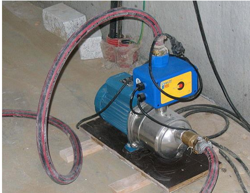
Fig. 4.8.4 Bomba de agua 126
