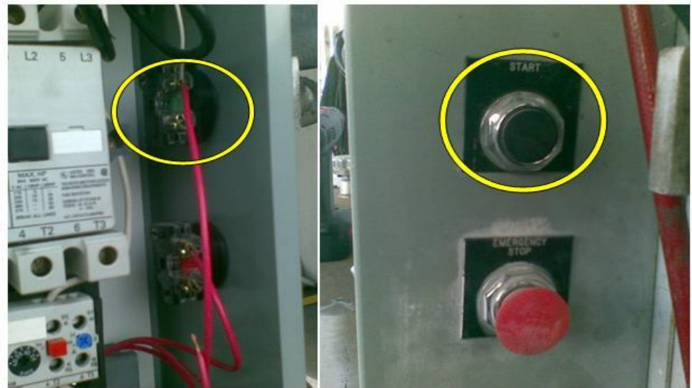
Fig. 5.2.1 Contactor original de START o inicio de operación 151
