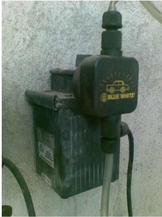
Fig. 4.8.6 Bomba dosificadora de Rinse 128
