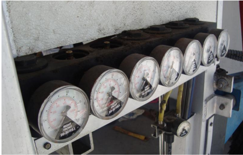
Fig. 2.6.16 Manómetros del Sistema car wash 61
