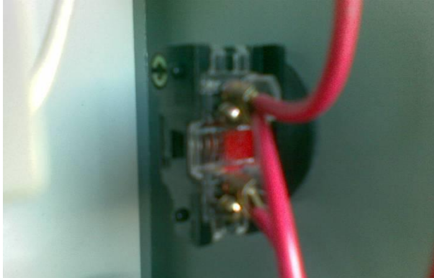
Fig. 4.8.8 Contacto de paro de emergencia original 130
