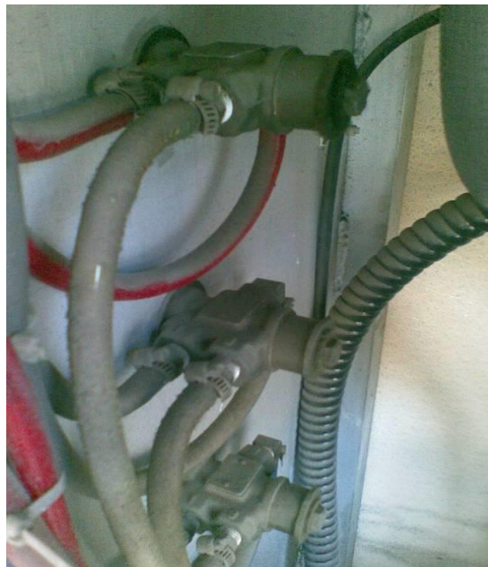
Fig. 4.4.1.2 Vista posterior de válvulas neumáticas 104
