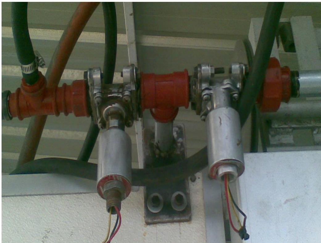
Fig. 5.1.2.2 Electroválvulas: izquierda de rinse y la derecha de shampoo 143
