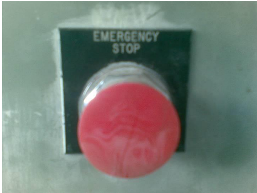
Fig. 4.4.1.7 Pulsador de emergencia original 109
