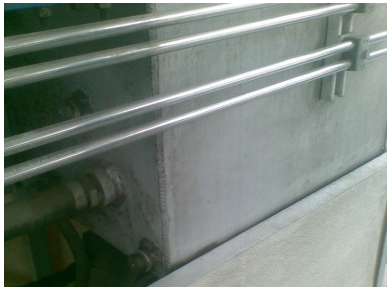
Fig. 5.1.5.2 Almacenamiento de aceite hidráulico 149
