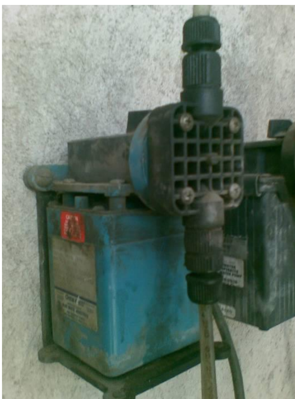
Fig. 4.8.3 Bomba dosificadora de Shampoo 125
