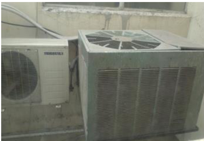
Figura 80. Equipos suspendidos. Bloque Central
