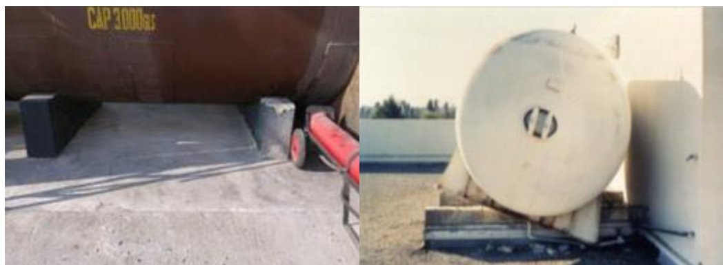
Figura 66. Izq. Apoyos. Tanque de combustible. Der. Foto FEMA E74
