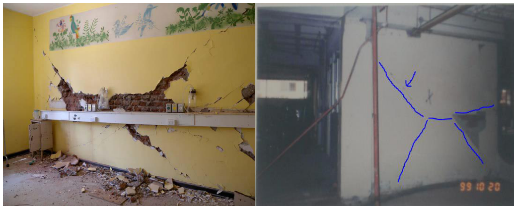
Figura 11. IZQ. Daño de pared en cuarto de hospitalización en el Hospital Félix Bulnes de Santiago en el sismo de Chile 2010. (FEMA-E74, 2011). DER. Daño de pared en el Hospital Miguel Alcívar en el sismo de Bahía de Caráquez de 1998. (Morales, Espín, Mier, & Vargas, 2000)
