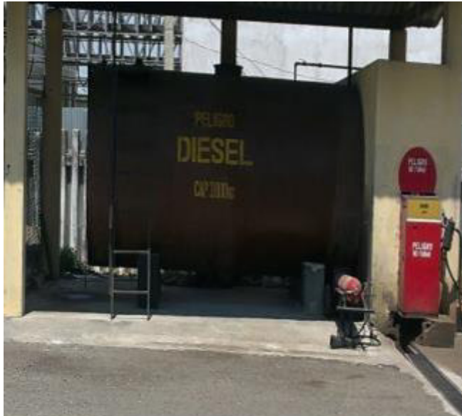
Figura 67. Tanque de combustible
