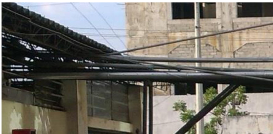
Figura 68. Casa de máquinas-Exterior. Hospital Militar de Guayaquil
