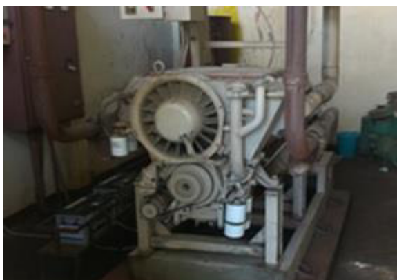
Figura 61. Casa de máquinas. Foto Hospital Militar de Guayaquil
