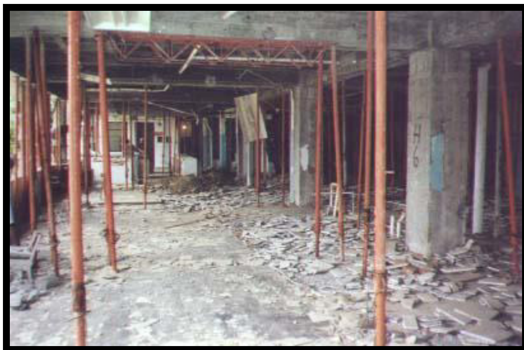
Figura 5. Daño estructural en la propiedad del Hospital Miguel H. Alcívar- Bahía de Caráquez, Manabí. (Cuerpo de Ingenieros del Ejército, 2000)
