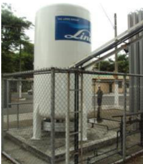
Figura 114. Tanque de Oxígeno, exterior Hospital Militar Guayaquil.
