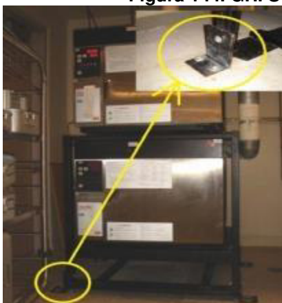
Figura 145. Equipo de esterilización. Foto FEMA 767
