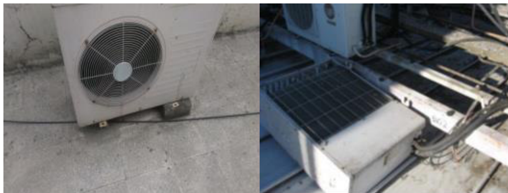
Figura 85. Izq. Terraza Hospital Militar de Guayaquil. Der. Foto FEMA E74 6.4.1.4-3
