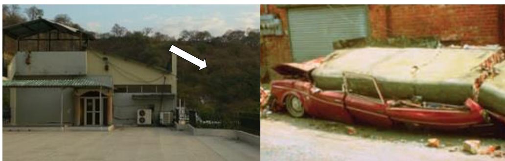
Figura 21. Izq. Posible Falla. Desprendimiento del parapeto. Der. Foto FEMA E74
