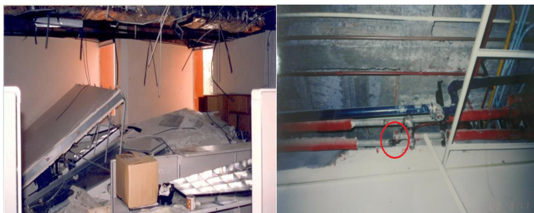
Figura 10. IZQ. Daño de particiones, cielo raso e iluminación en el terremoto de Northridge. (FEMA-E74, 2011). DER. Daño de tubería del Hospital Miguel Alcívar en el sismo de Bahía de Caráquez de 1998. (Morales, Espín, Mier, & Vargas, 2000)
