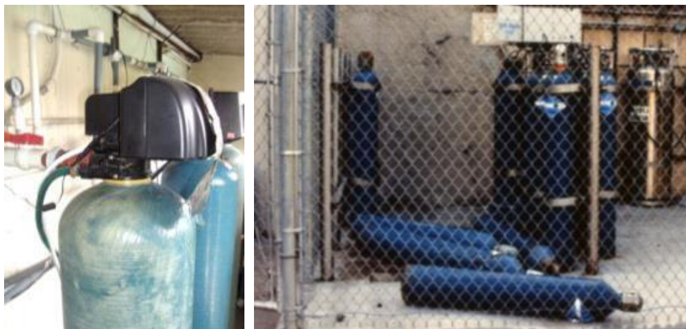
Figura 119. Izq. Conexiones de gas médico. Der. Foto FEMA E74 6.4.2.3-1
